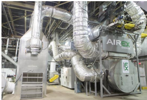
Optimisation des systèmes de contrôle énergétique
