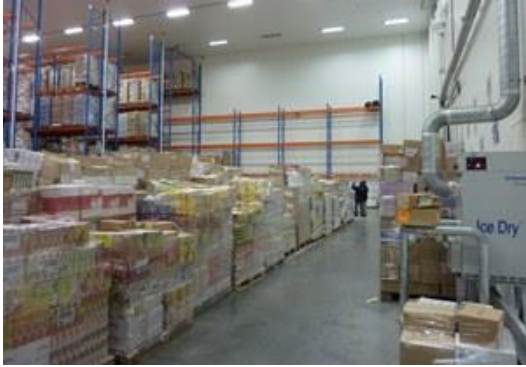
Gestion centralisée des températures dans les entrepôts
